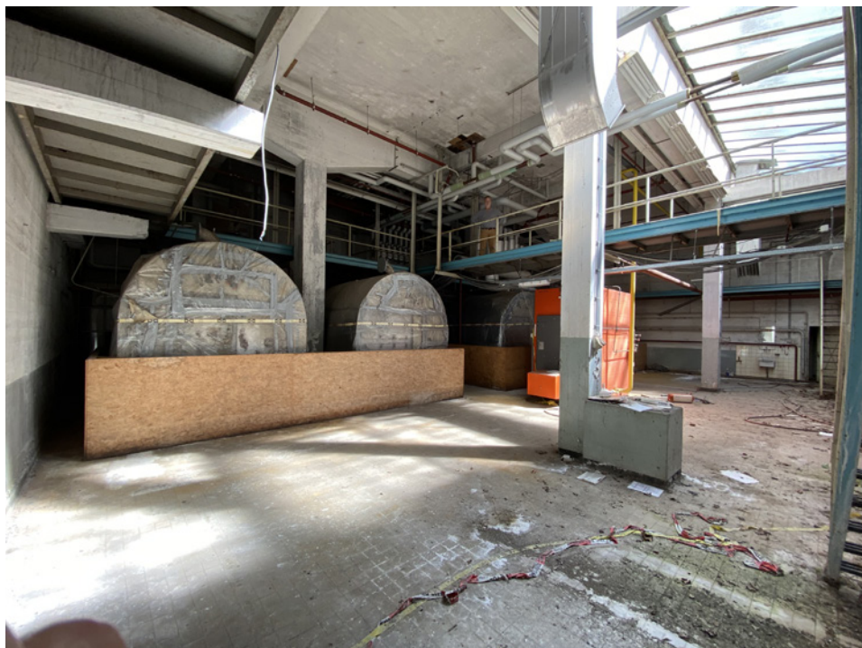
Het interieur van het ketelhuis
