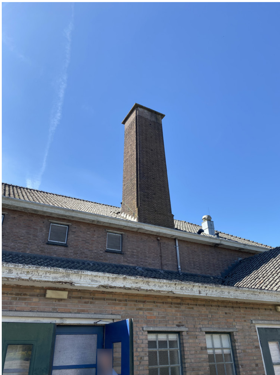
Schoorstenen van het keukengebouw. Let op de sprong in het metselwerk op de hoeken, 2020
