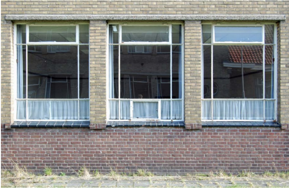
Vensters van de Elias Beekmanskazerne in Ede (Bouwhistorisch onderzoek Elias Beekmankazerne in Ede, Arcx)
