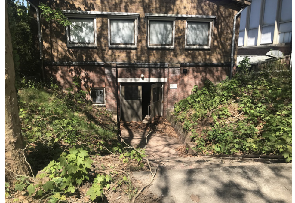
Gebouw 12 is eind jaren zestig gebouwd op de vooroorlogse kolenkelder aan de westzijde van het keukengebouw
