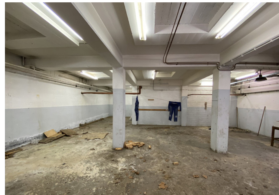
Interieur van de voormalige kolenkelder. Let op de sparingen voor de daklichten die later met beton zijn dichtgemaakt
